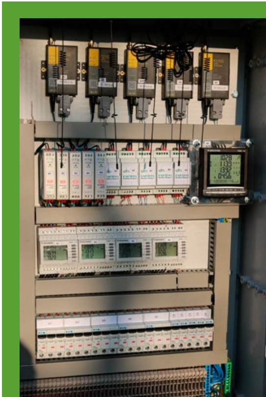
3. KÉP: A TRANSZFORMÁTORÁLLOMÁSBAN TELEPÍTETT MÉRŐK ÉS KOMMUNIKÁCIÓS EGYSÉGEK
