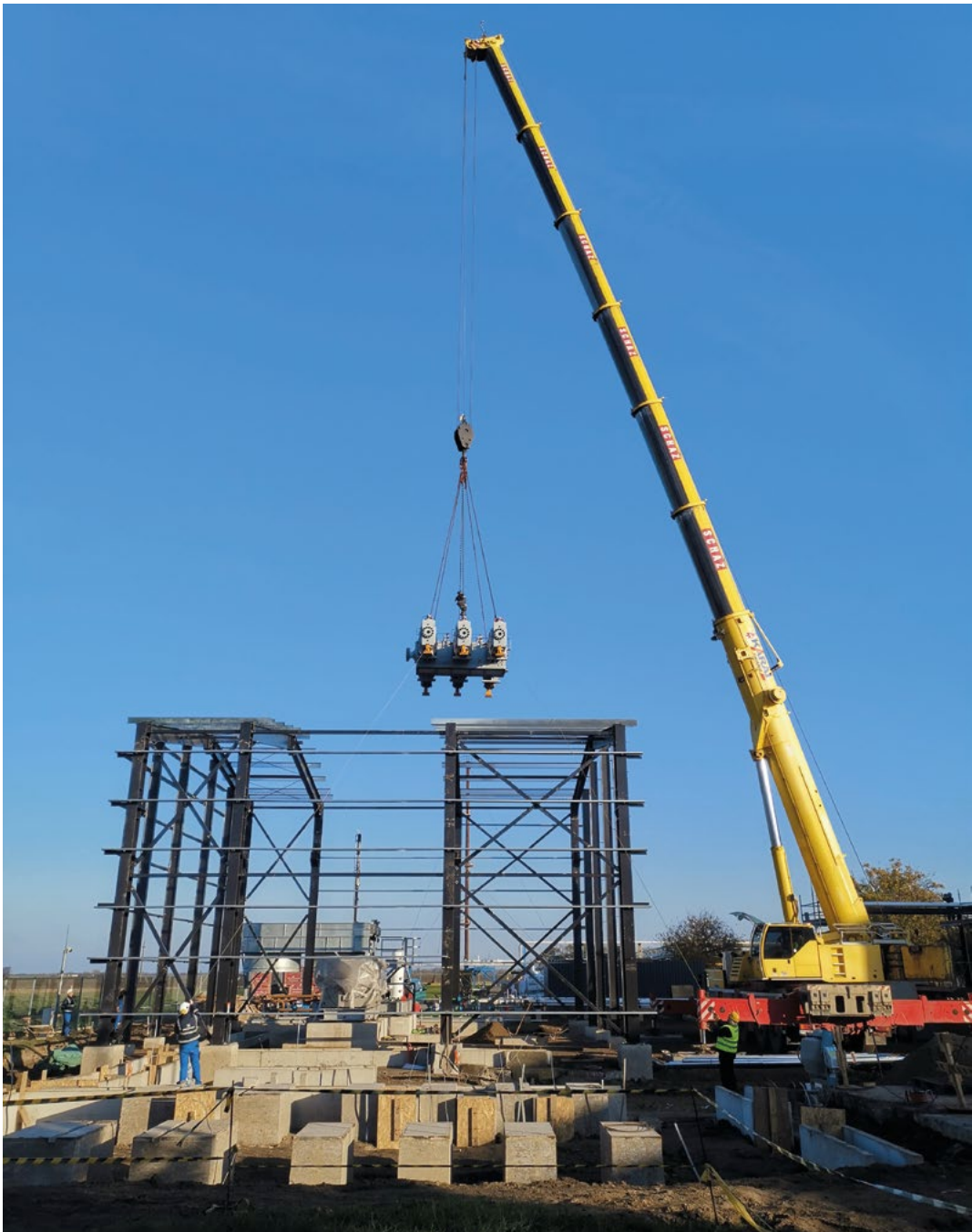
A KARDOSKÚTI VILLAMOS KOMPRESSZOR BEEMELÉSE 2020 NOVEMBERÉBEN
